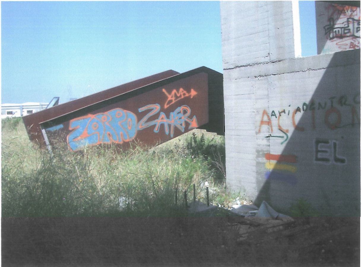
Sobre el pabellón de recepción y sus elementos anexos aparecen numerosas pintadas.
