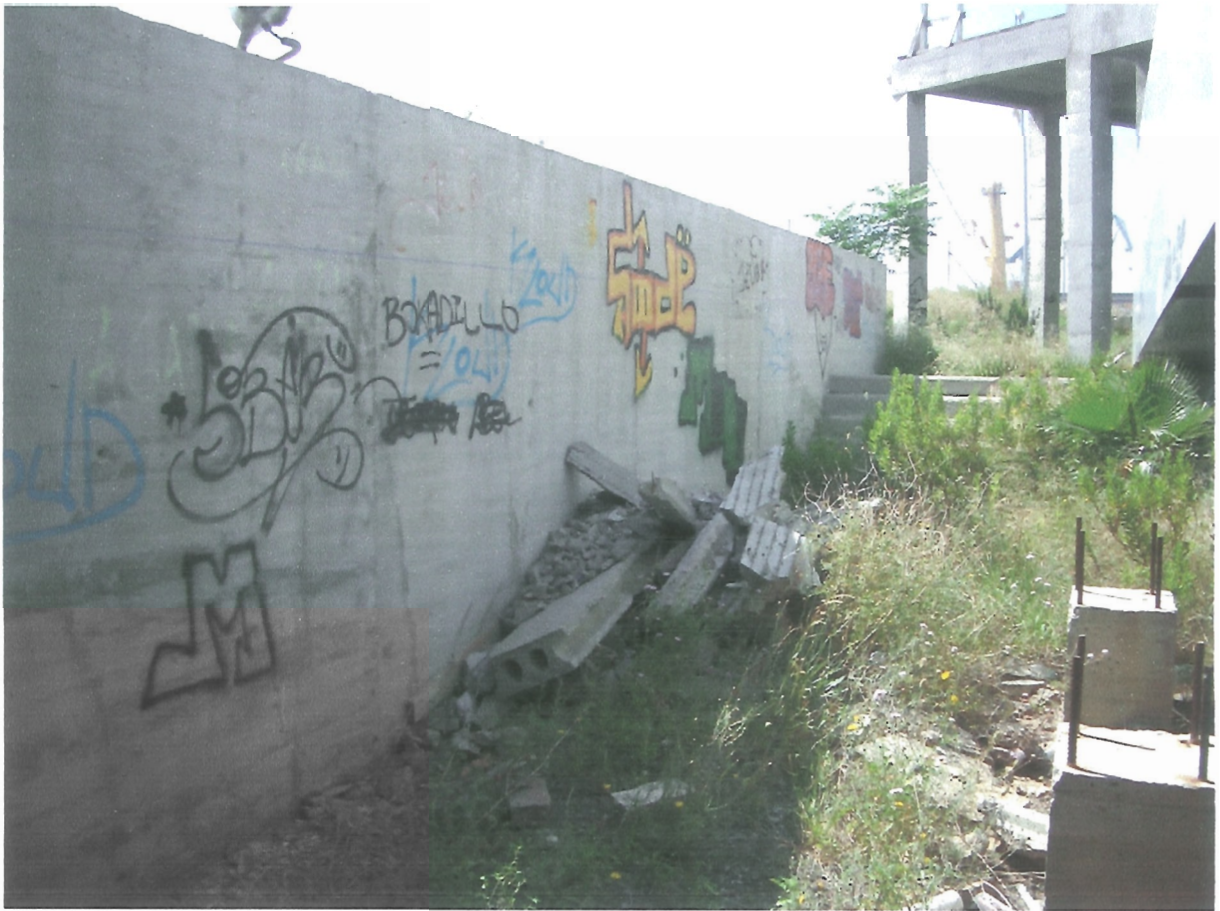
Estado actual de la base del pabellón de recepción.
